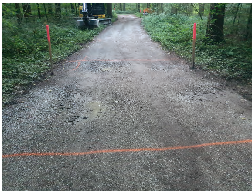
Chemin avec nids-de-poule avant réfection
